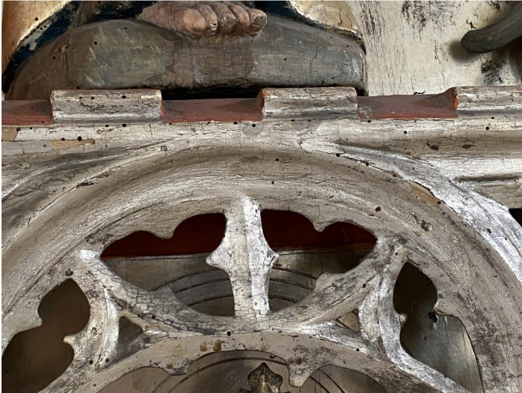
Fot. 15. Widoczne otwory po żerowaniu kołatka
